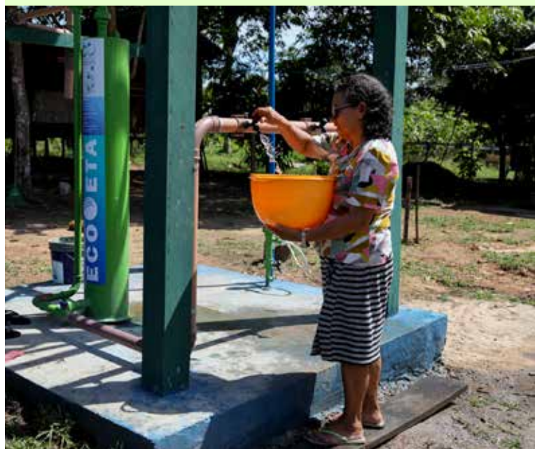
Na Comunidade São Francisco do Aruaú, interior do Amazonas, sistema de abastecimento de água potável movido a energia solar transformou a vida das famílias locais, 2025 – Foto: Michael Dantas
